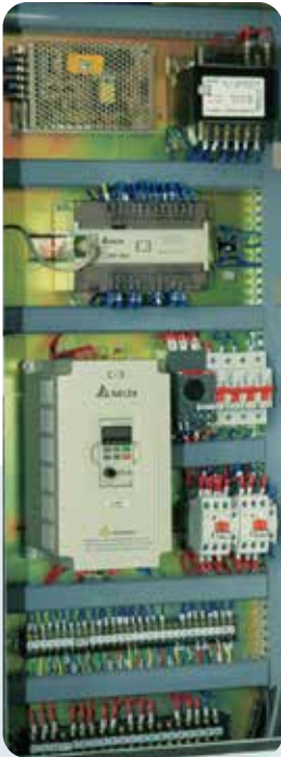
↑ 电气控制 Electrical control
